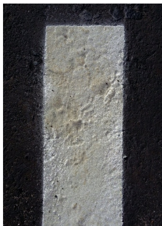
Amarelamento X cura asfáltica
